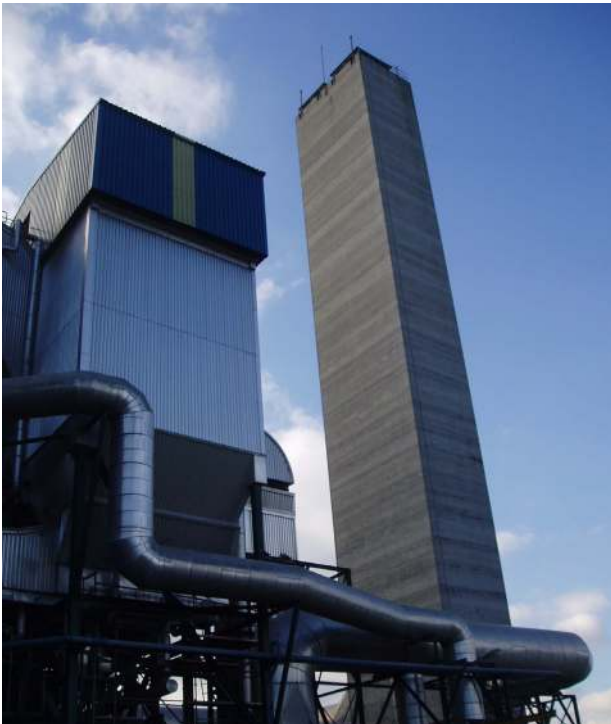
Sistema de lavado de gases y torre de emisiones de una incineradora
